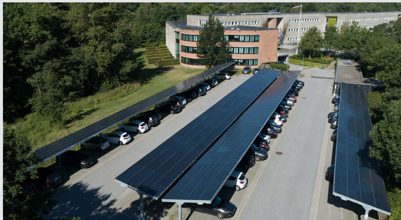
Fredensborg Kommune har i 2015 etableret et solcelleanlæg på rådhusets parkeringsplads.
