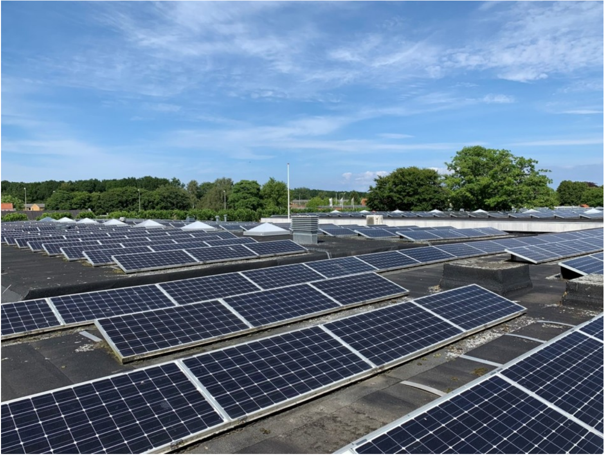
Solceller på tagfladen af administrationscenteret i Munkebo.
